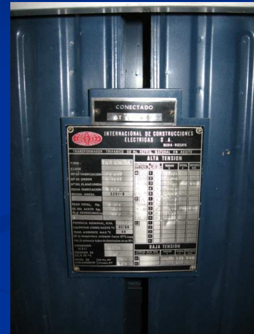
Placa de características del transformador
