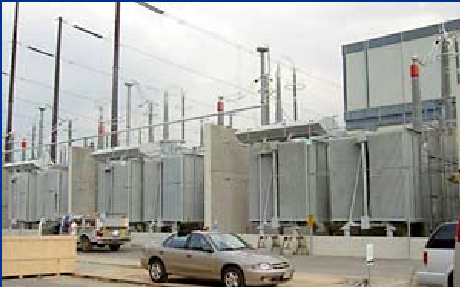
Banco (3 monofásicos) de 360 MVA
