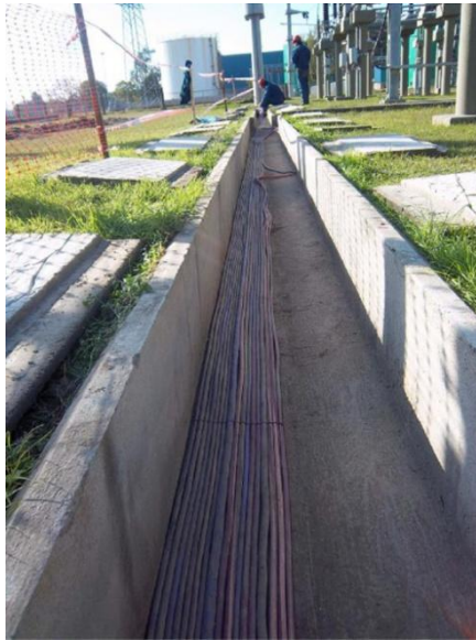
Figura A.246. Canalización de cables en subestación eléctrica. Fuente: Proa.
