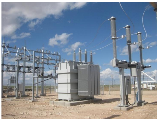
Figura A.137. Sensores montados sobre interruptor para medir corrientes de línea.
