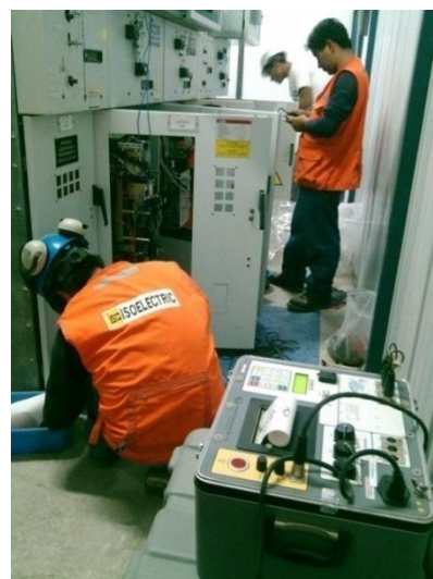
Figura A.253. Pruebas en un interruptor de potencia extraíble. Fuente: Corpoelec.
