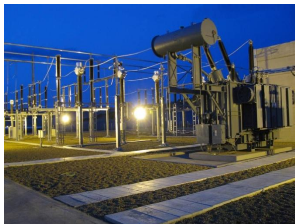
Figura A.179. Alumbrado exterior de una subestación.
