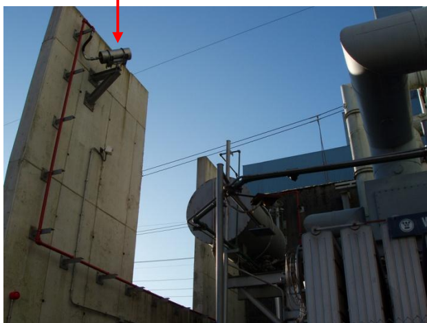
Figura A.178. Protección contra incendios de un transformador con un cañón de espuma.
