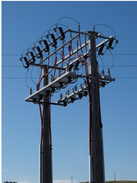
Figura A.172. Banco de capacitores monofásicos.
