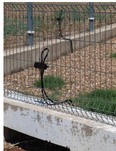
Figura A.175. Puesta a tierra en la valla de una subestación.
