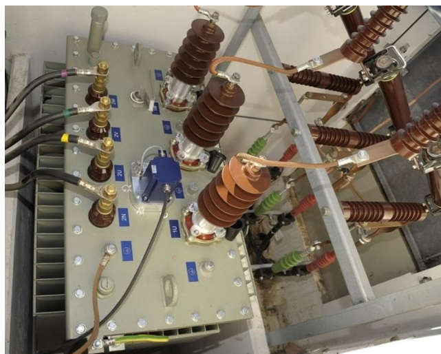
Figura A.262. Vista general del transformador de distribución con regulación en carga motorizado. Fuente: Reinhausen.
