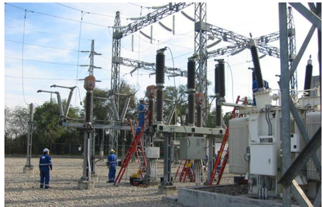
Figura A.247. Mantenimiento a distintos equipos de una subestación eléctrica. Fuente: Syse.
