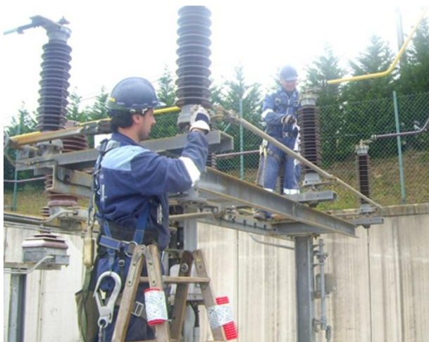
Figura A.248. Mantenimiento en seccionadores. Fuente: Sagova.
