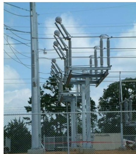
Figura A.93. Barras de una subestación.
