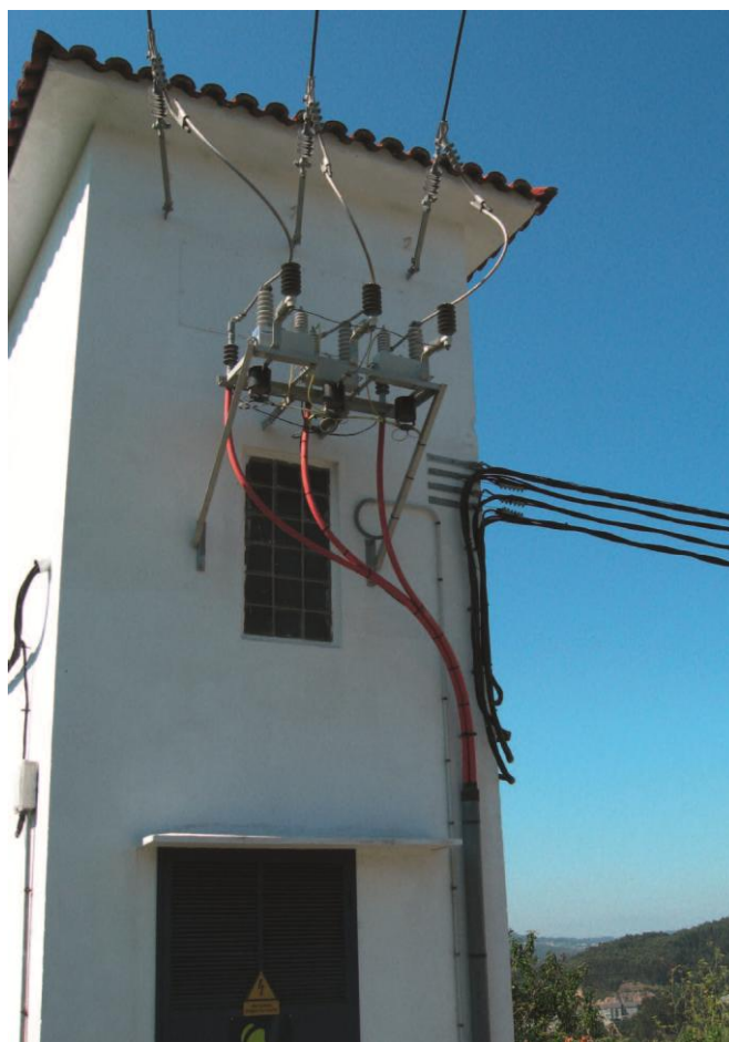
Figura A.133. CT con autoválvulas-pararrayos.
