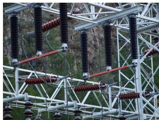
Figura A.153. Seccionador con la cuchilla en la parte inferior.
