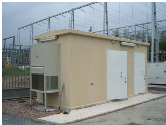
Figura A.183. Caseta de comunicaciones de una subestación.
