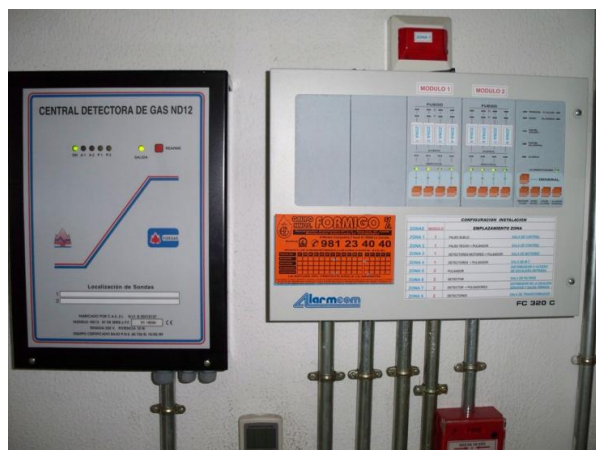
Figura A.11. Central detectora de gas.
