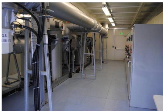
Figura A.215. Vista interior de SGI (subestación GIS integrada). Fuente: ABB.
