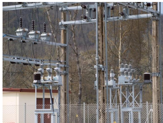
Figura A.151. Reconectores de una subestación.
