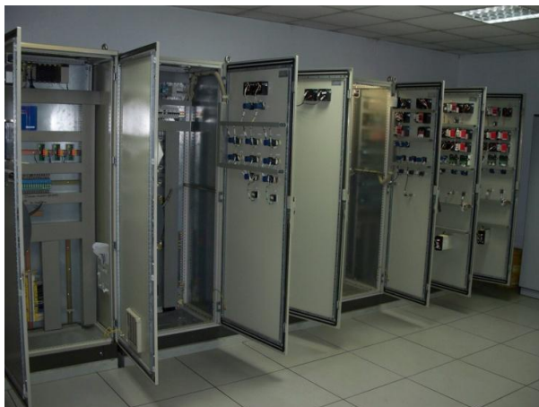
Figura A.15. Armarios de la sala de mando y control de generación.
