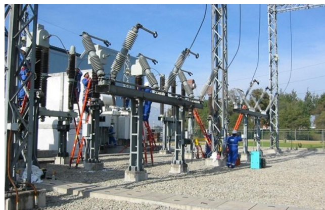
Figura A.155. Seccionadores en V. Fuente: Syse.
