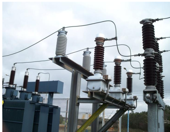
Figura A.16. Aparamenta.
