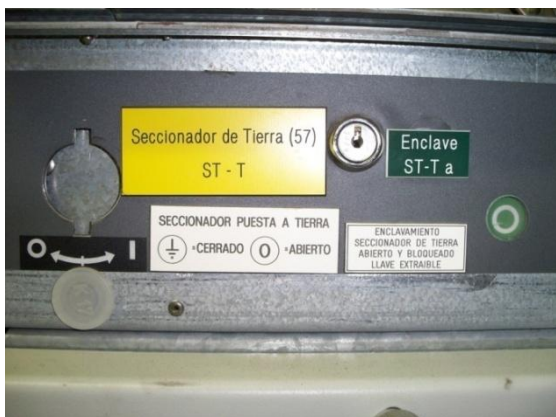
Figura A.45. Enclavamiento de seccionador de tierra.
