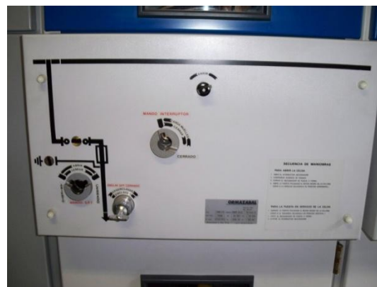
Figura A.46. Celda de interruptor y puesta tierra.
