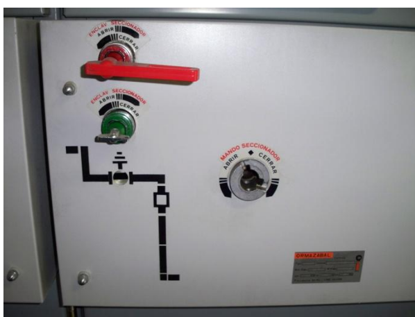
Figura A.47. Enclavamiento de seccionador.
