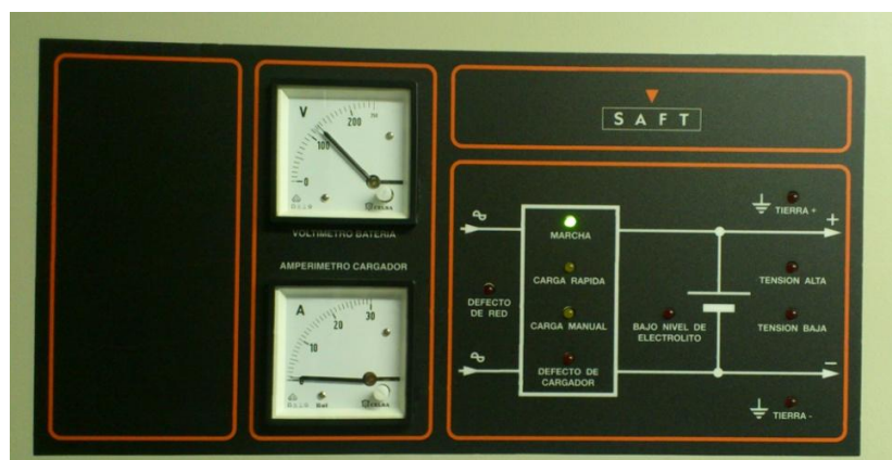
Figura A.14. Cuadro de protecciones de baterías de 110 Vcc.
