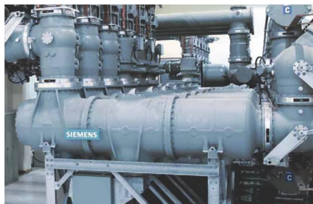
Figura A. 194. Interruptor de potencia de tipo horizontal de una subestación GIS.
