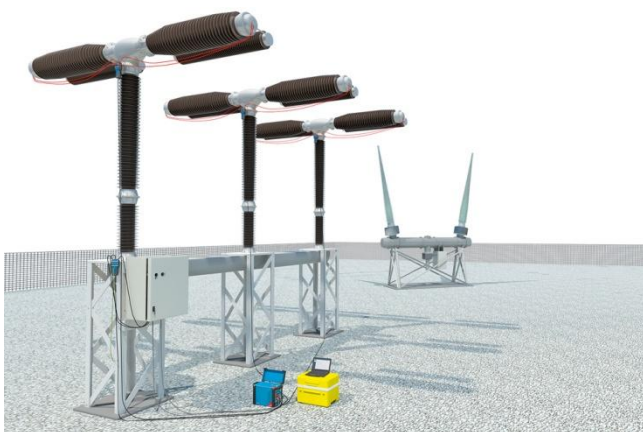
Figura A.252. Pruebas en un interruptor de intemperie. Fuente: Omicron.
