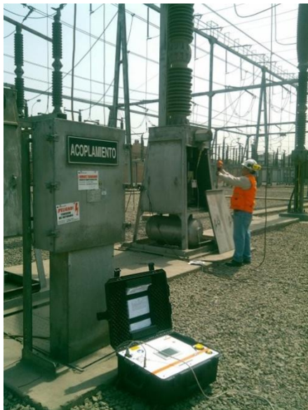
Figura A.254. Análisis en un interruptor de potencia. Fuente: Isoelectric.
