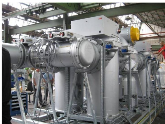
Figura A.214. Cableado de SGI (subestación GIS integrada). Fuente: ABB.
