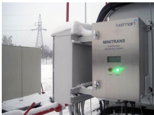
Figura A.28. Unidad de supervisión de transformador multi-gas. Fuente: Kelman.
