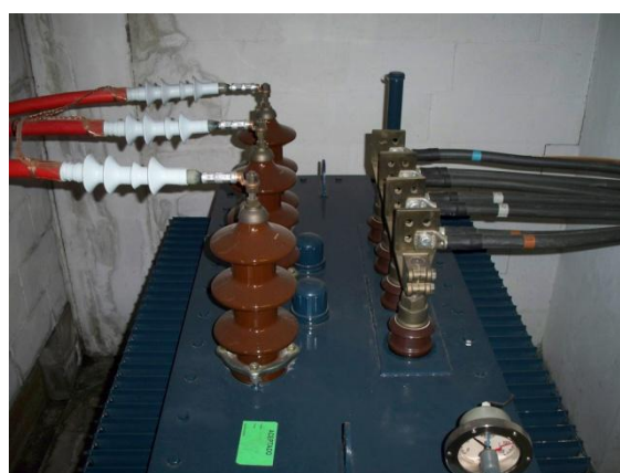
Figura A.5. Transformador de servicios auxiliares.
